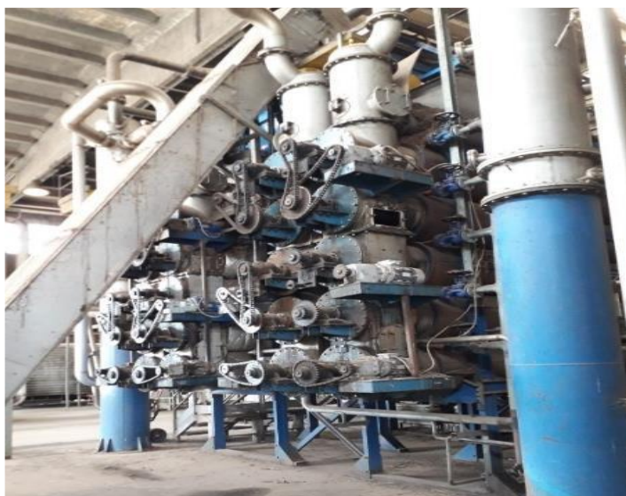
Figura 5: Impianto di disalcolazione
