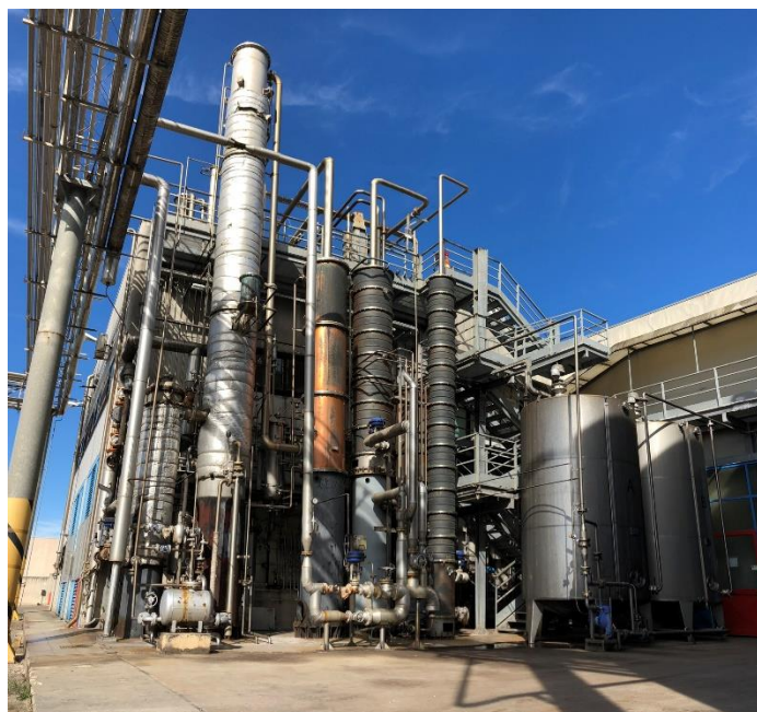
Figura 7: Impianto di distillazione
